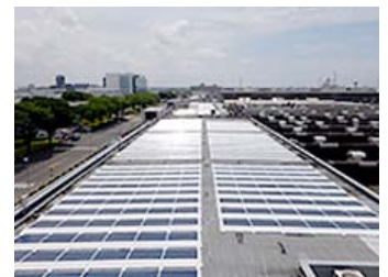
藤沢工場太陽光発電パネル
