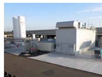
栃木工場コージェネレーションシステム
