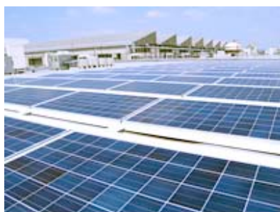
藤沢工場太陽光発電パネル
