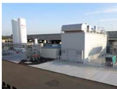
栃木工場コージェネレーションシステム
