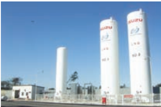
液化天然ガス (LNG) プラント
