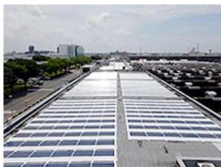
藤沢工場太陽光発電パネル
