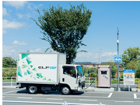
事業化された公道充電ステーション
