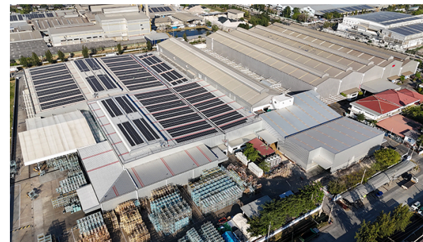
タイ インターナショナル ダイ メイキング（TID）の太陽光発電設備
