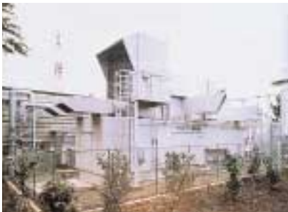
コジェネレーション設備
