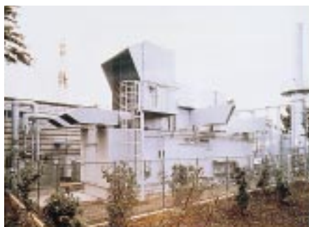
コジェネレーション設備
